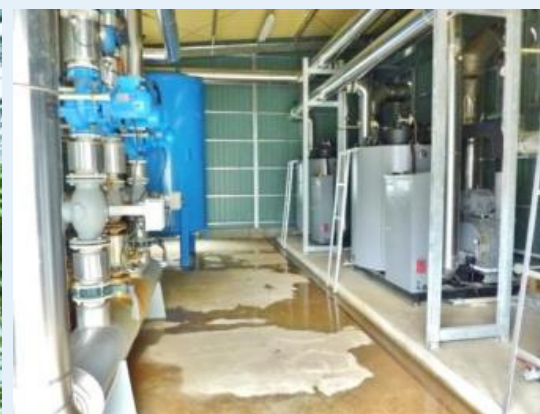
ボイラー室内 INSIDE of BOILER ROOM
